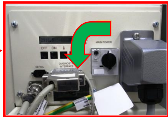
冷凍機 MAIN POWER
