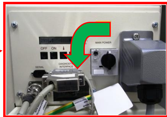
冷凍機 MAIN POWER
