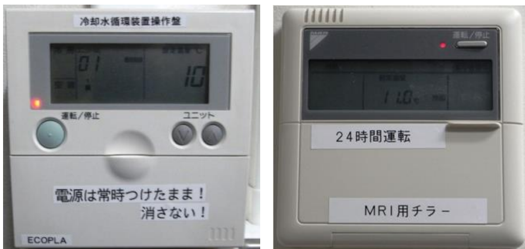
チラー遠隔操作盤の一例
