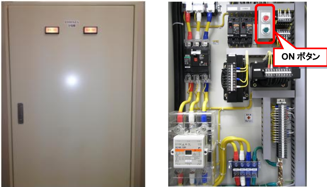
分電盤の一例
