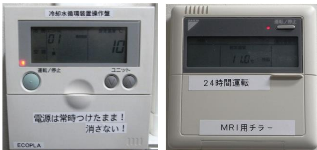
チラー遠隔操作盤の一例
